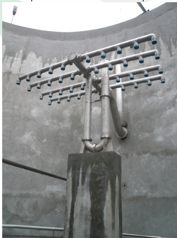
Siphon de reprise de l'eau épurée
